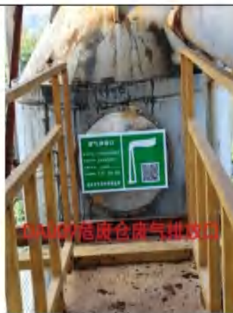
图 4.2-12 废气排放口及标识牌 (DA009)
