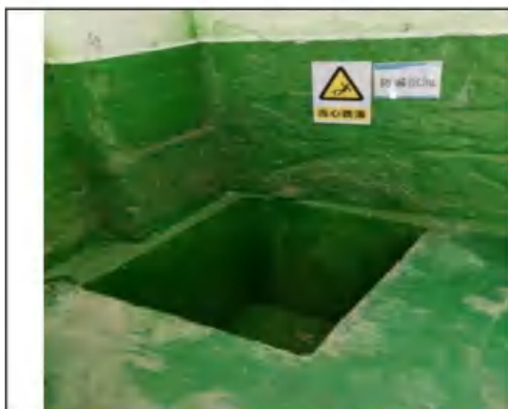
图 4.2-5 厂区内事故废水收集井
