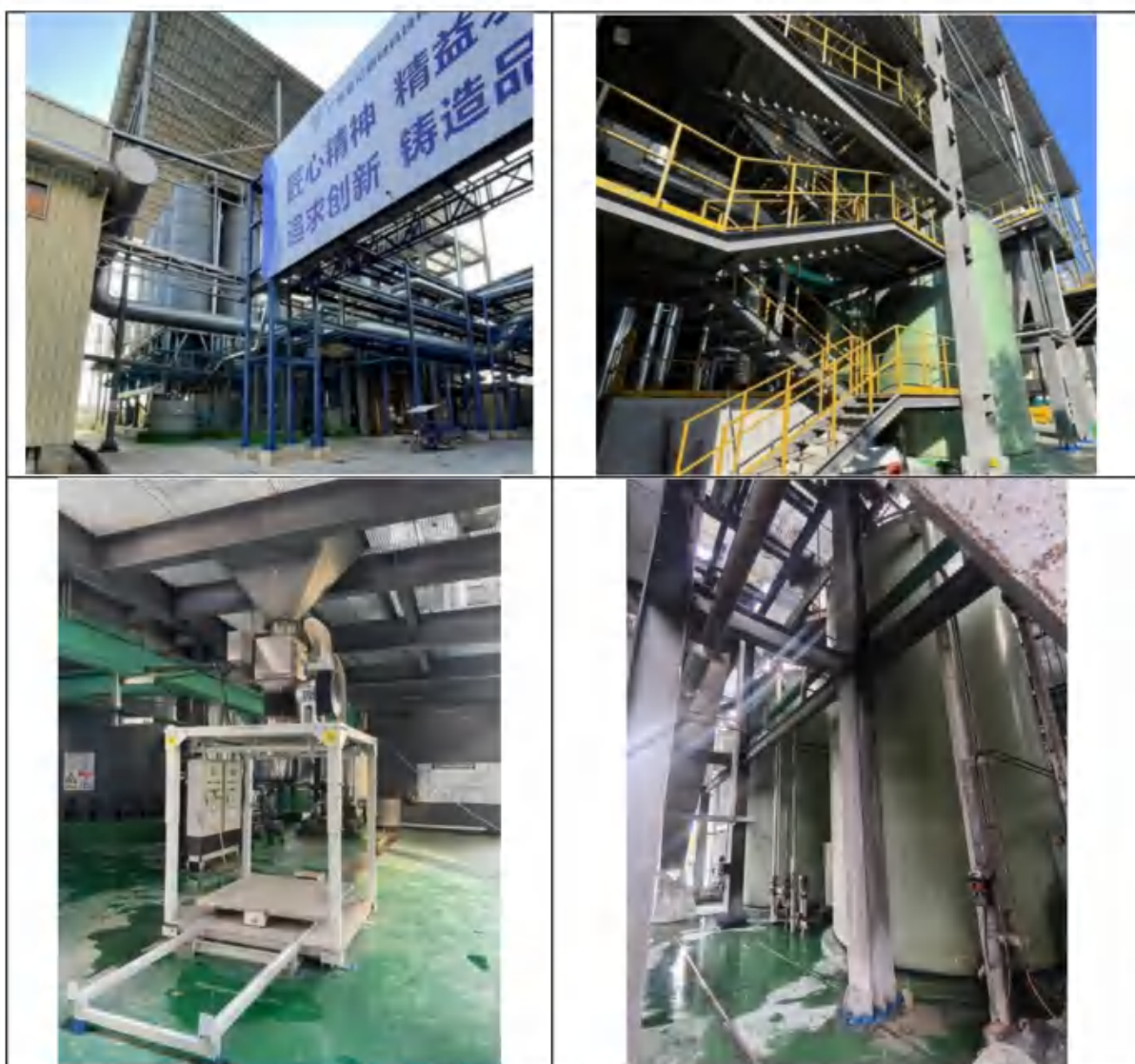
图 4.1-1 废水处理设施
